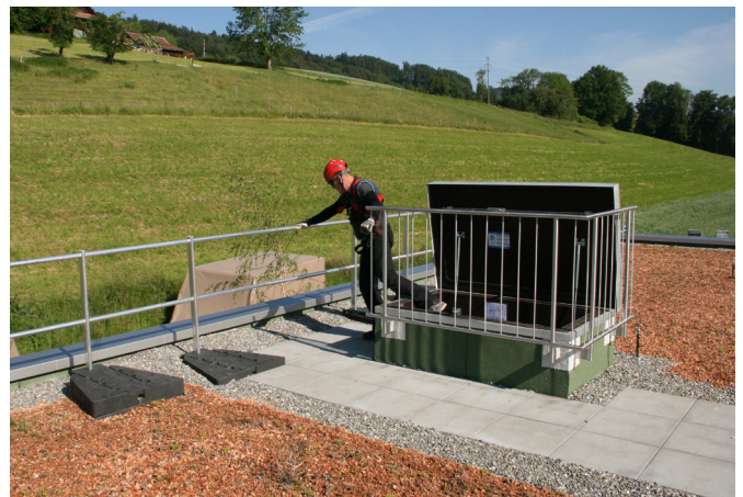
Abb. 37: Dachausstieg durch Seitenschutz aus dem Gefahrenbereich mit hoher Absturzgefahr gesichert. Optimal geplant würde der Dachausstieg in den inneren Gefahrenbereich führen
