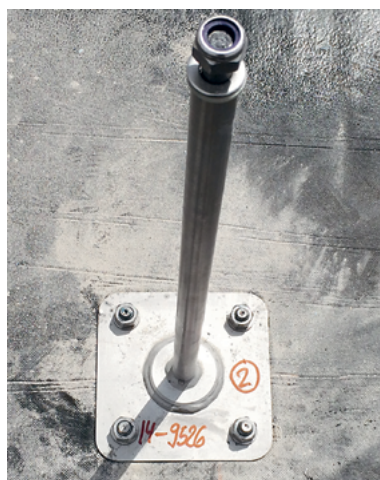
Fig. 43: Supporto completamente assemblato e numerato per la documentazione di installazione (Numero dell'oggetto e numero del supporto, tutti i fissaggi visibili)
