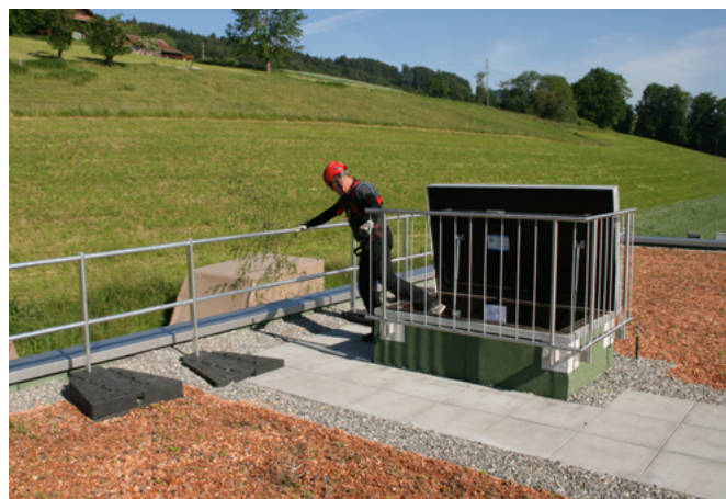
Fig. 38: Uscita dal tetto assicurata da una protezione laterale dalla zona pericolosa ad alto rischio di caduta. Se pianificata in modo ottimale, l'uscita dal tetto porterebbe alla zona di pericolo interna.
